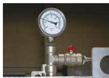
Détection de fuite
